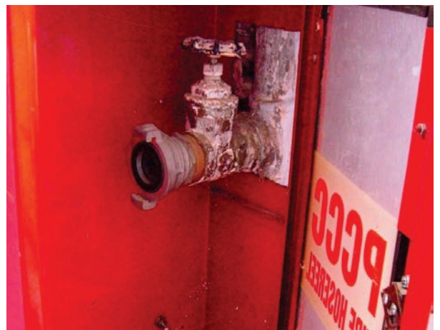
Phòng cháy, chữa cháy? Khoá nước hỏng, không vòi nước.
