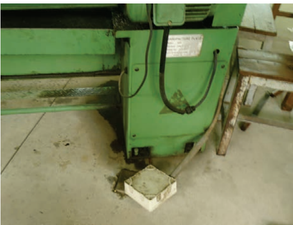
Công tác an toàn điện chưa được bảo đảm
