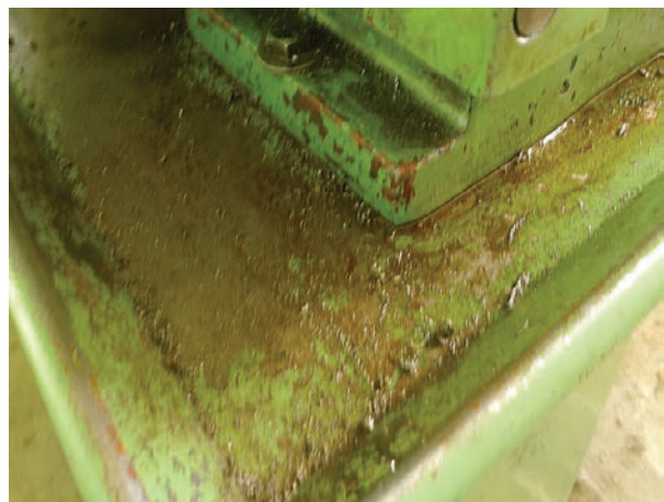
Công tác vệ sinh kém
